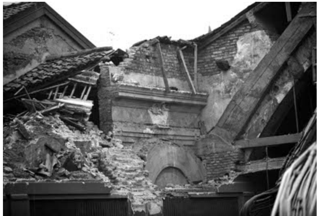
Ecco quanto resta dello storico Marzani: in piedi ormai sono rimasti solo alcuni muri che saranno presto abbattuti
